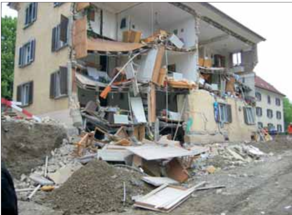
Horrorszenario für jeden Bauherrn: Bei Umbauarbeiten stürzt die Fassade eines Wohnhauses ein. Bild: zvg
